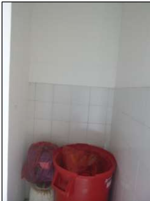
Ilustración 77. No hay Señalización U.S.S. Casa de Teja.
