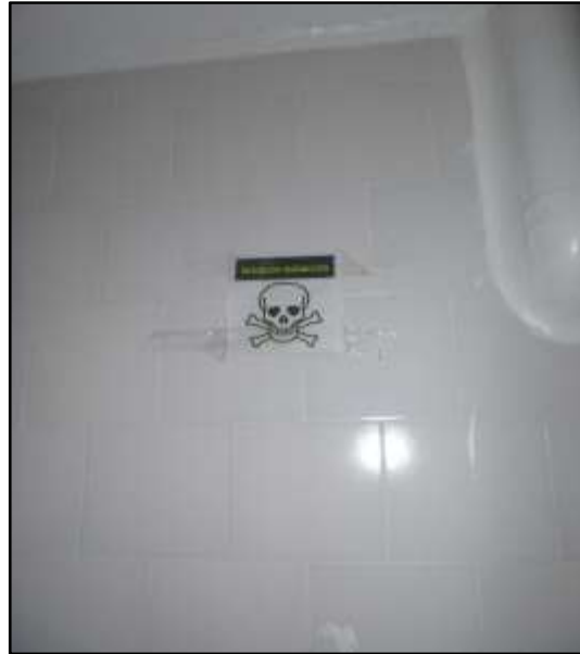
Ilustración 111. Señalización que no permite limpieza y desinfección
