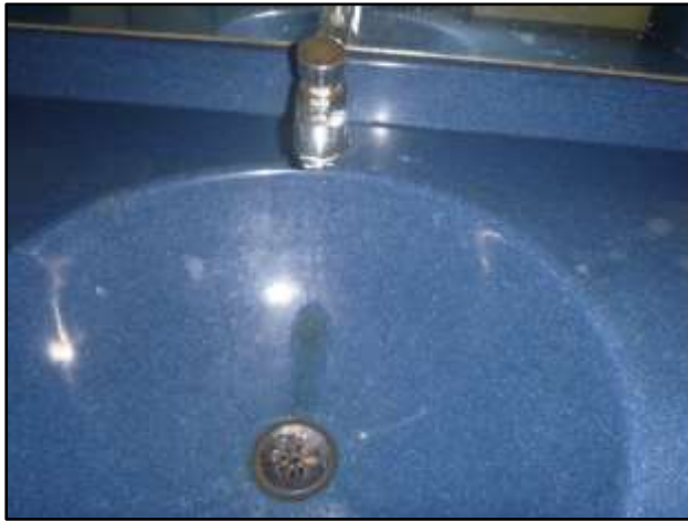
Ilustración 15. Goteo grifo 5 piso U.S.S. Meissen
