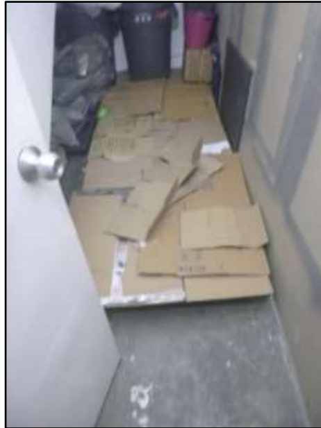
Ilustración 82. No cuenta con paredes a media caña.
