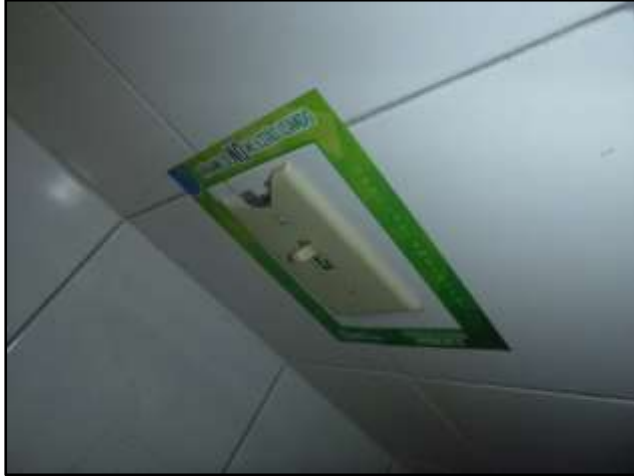
Ilustración 70. Switch dañado 4 piso U.S.S. Meissen.
