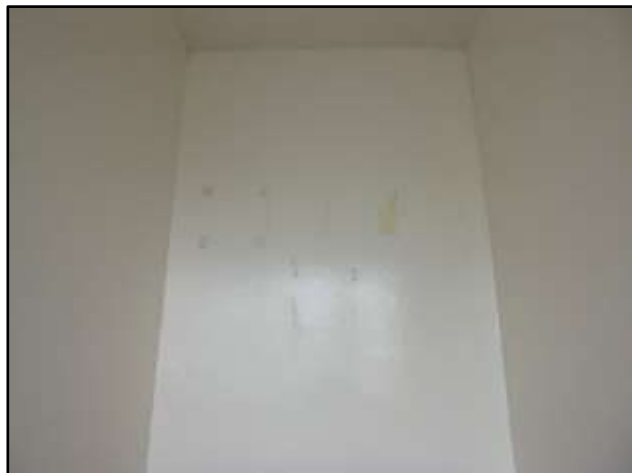
Ilustración 100. No se observa señalización adecuada U.S.S. Jerusalén.
