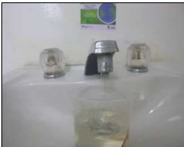
Ilustración 13. Fuga en grifo C.A.P.S. Vista Hermosa incontrolada Urgencias.
