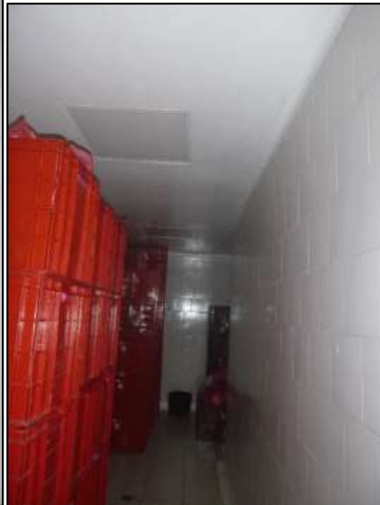
Ilustración 113. No se observa señalización
