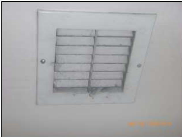
Ilustración 72. Rejilla de ventilación sucia, U.S.S. Meissen
