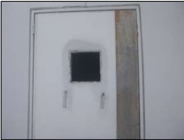
Ilustración 91. No cuenta con señalización Adecuada, U.S.S. Candelaria II.
