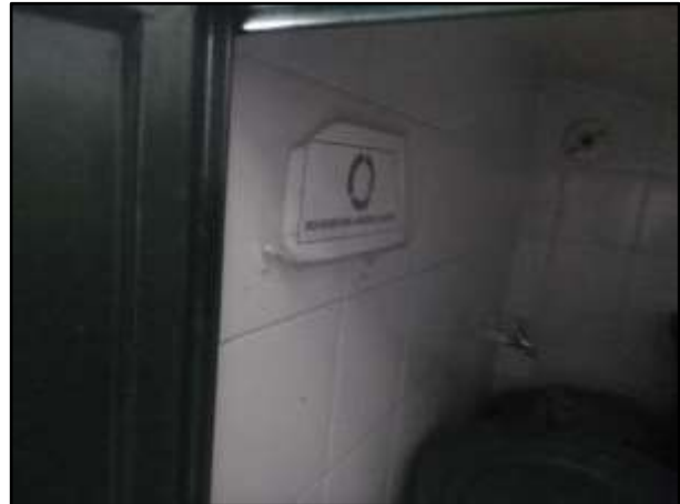
Ilustración 94. Señalización que no permite limpieza y desinfección, U.S.S. Candelaria II.
