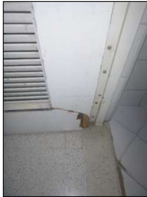
Ilustración 69. Puerta rota 4 piso. U.S.S. Meissen
