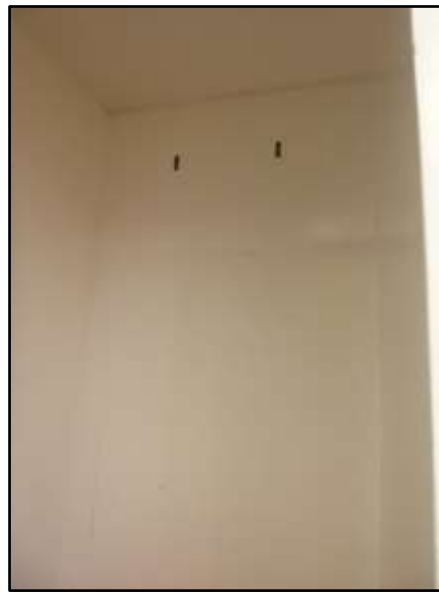
Ilustración 87. No cuenta con correcta señalización
