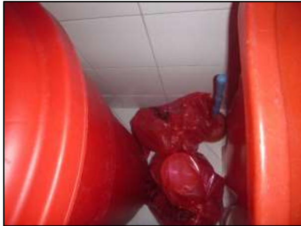
Ilustración 65. Residuos incorrectamente almacenados U.S.S. Meissen.
