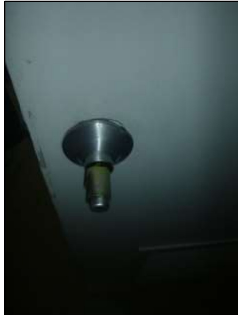
Ilustración 71. Chapa dañada Almacenamiento Intermedio U.S.S. Meissen.
