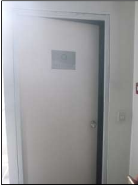
Ilustración 81. Señalización que no permite correcta limpieza y desinfección.
